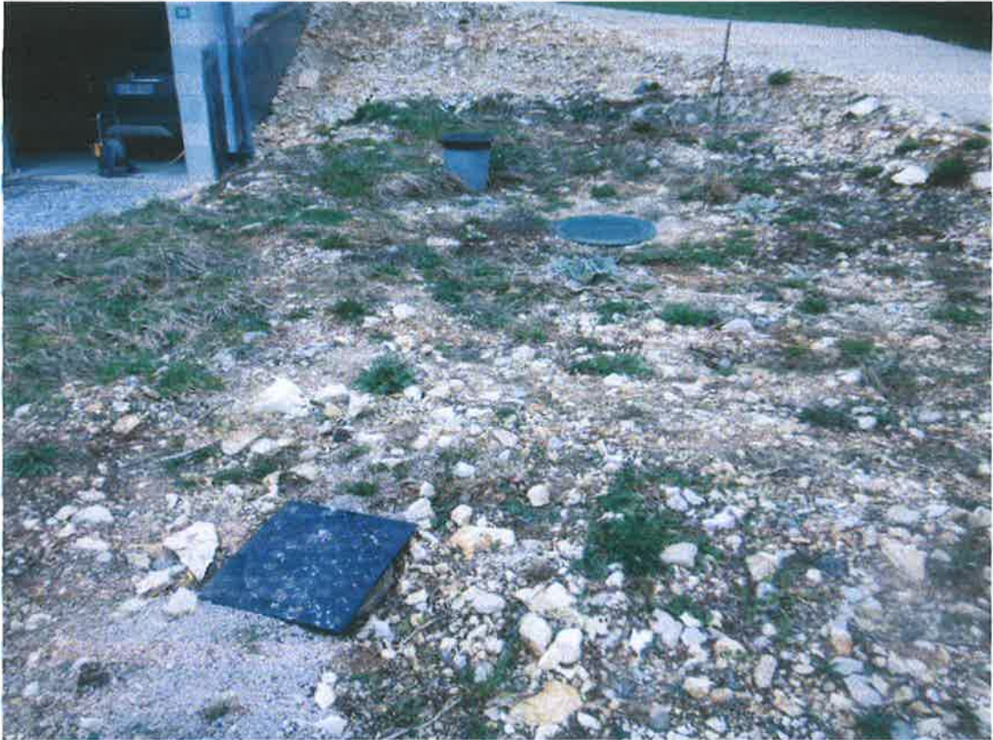
Fosse toutes eaux et lit d'épandage devant une maison d'habitation très récente
