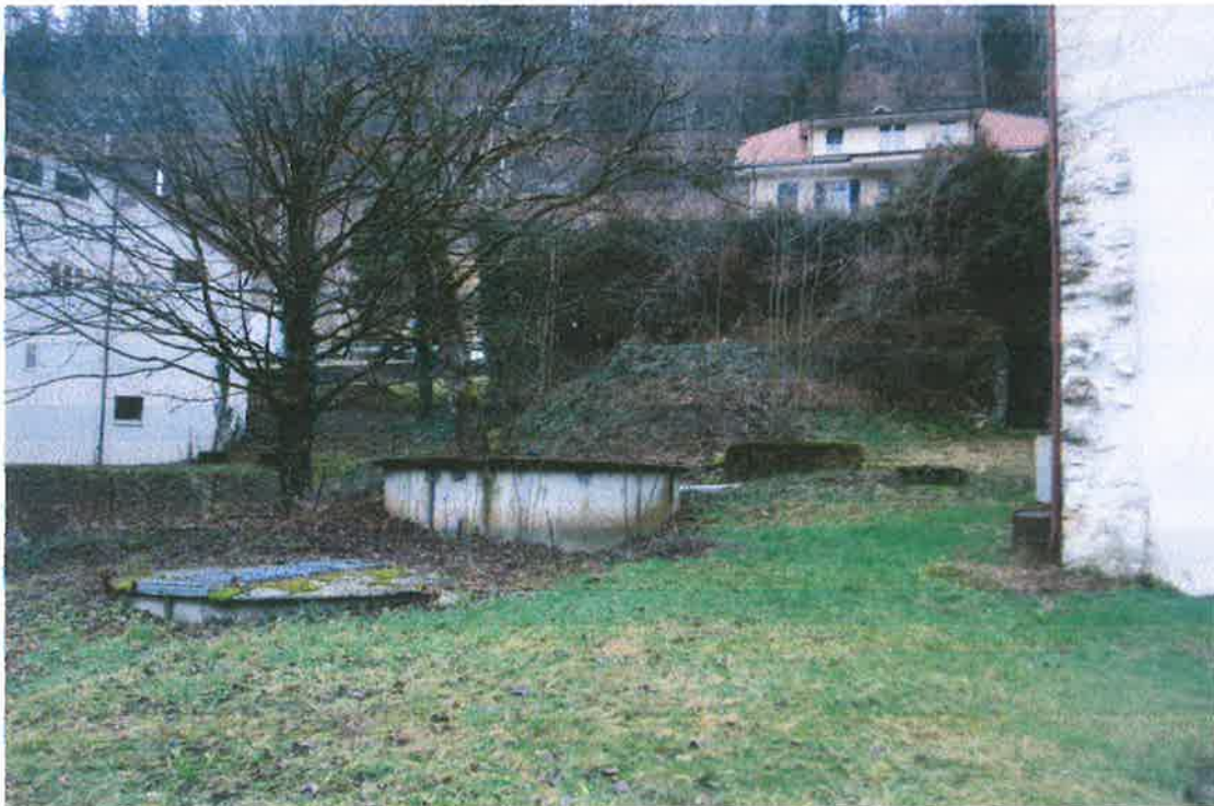
Fosse septique de l'ensemble des bâtiments Saint-Bernard
