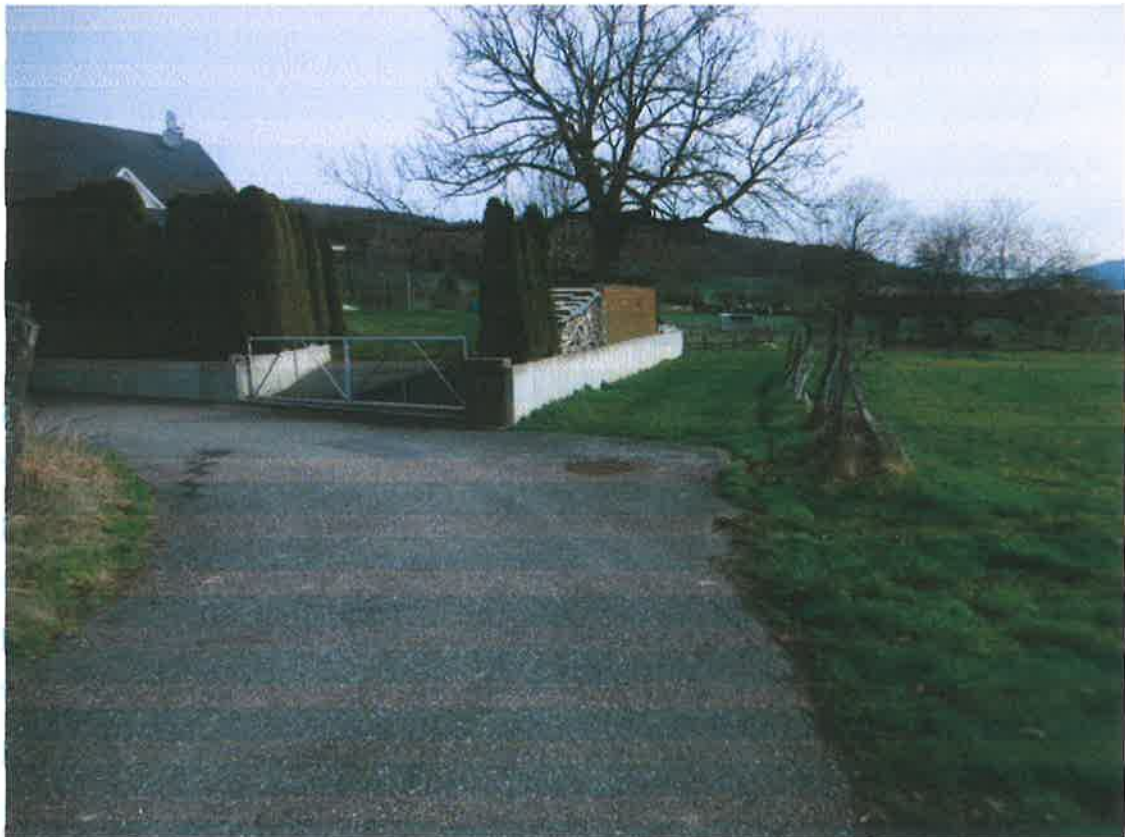
Station de relevage du Kaiweg (sous chaussée)
